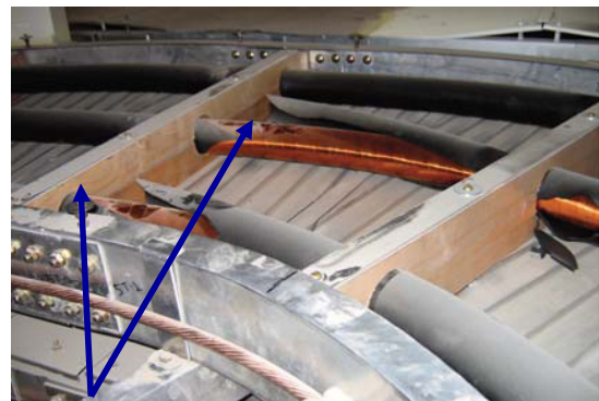
水疗院低烟零无卤素电缆安装失败
